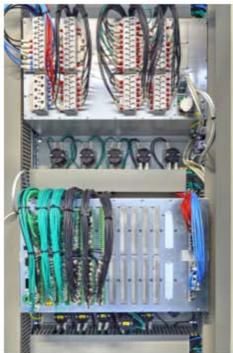
Defekte an elektrischen Anlagen
